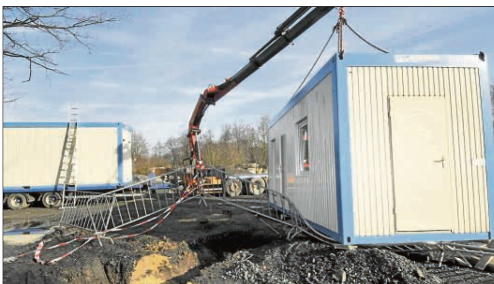
Die tonnenschwere Container-Last hat die schweren Absperrgitter zermalmt. So gesehen hat der 55-jährige Arbeiter, der von dem Container erwischt wurde, noch Glück im Unglück gehabt. ■ Foto: Dahm
