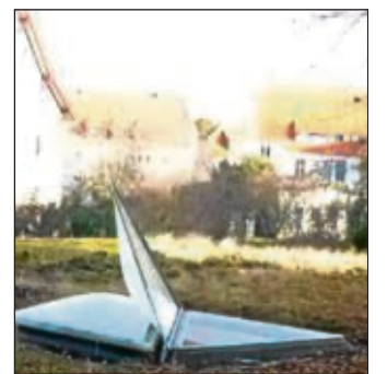
Durch diese Dachluke stiegen die Täter in den Kindergarten ein. ■ Foto: Polizei
