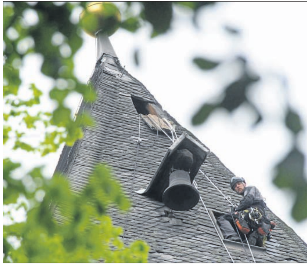
Arbeitsplatz in luftiger Höhe: Industriekletterer führten an Pauli Reparaturen durch. ■ Foto: Dahm
